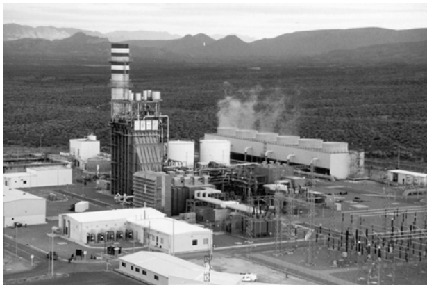
Fig. 1 Vista de central eléctrica de ciclo combinado CCC.
